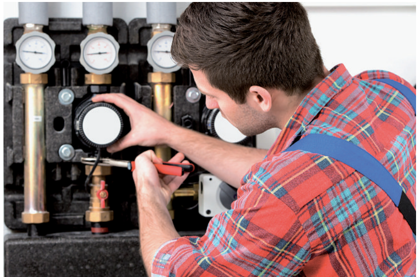
Regelmässiger Service verlängert die Lebensdauer der Heizanlage.
