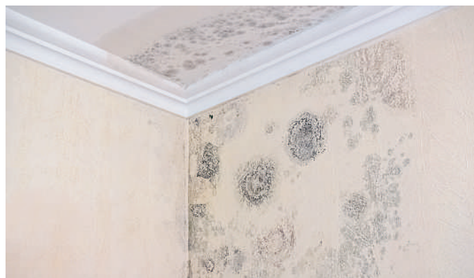
Beispiel: Akuter Schimmelpilzbefall vor der Sanierung
