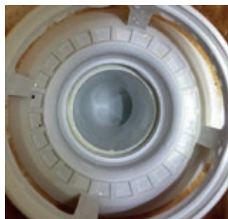
Entkalktes Spülrohr nach Service
